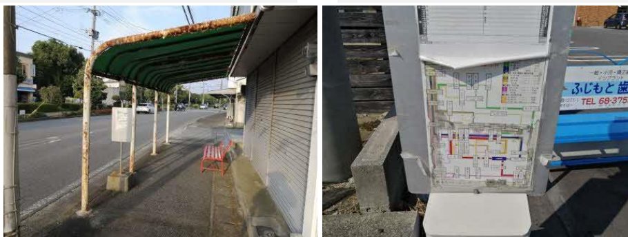
図 4-80 老朽化しているバス停下屋・バス停標柱の整備不良状況
